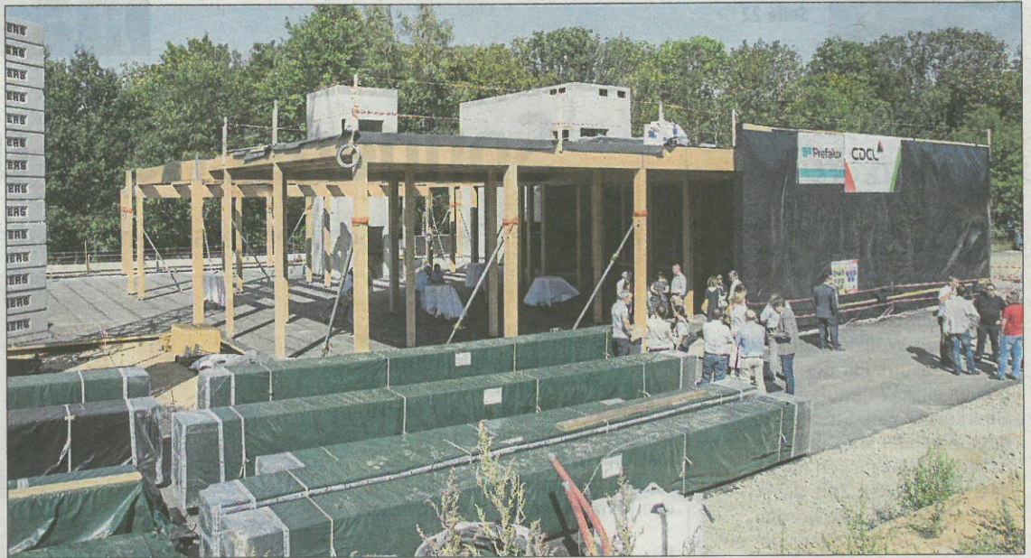
Der Grundriss der neuen Unterkunft in der Rue de Neudorf ist allmählich zu erkennen. Im Januar war mit den Bauarbeiten begonnen worden. (FOTO: GUY JALLAY)
